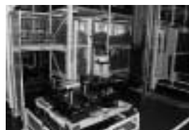
●自動倉庫ラック
